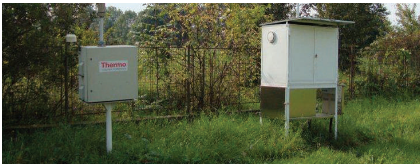
Stávající měřící zařízení v budoucnu nahradí automatická monitorovací stanice.
