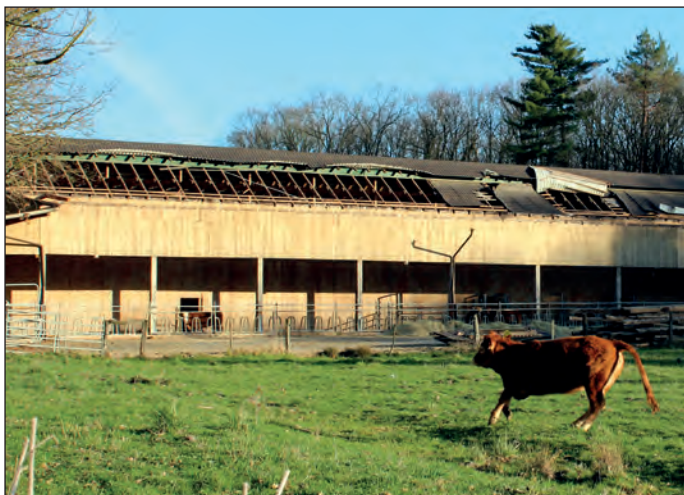
Při březnové vichřici byla vážně poškozena střecha hospodářské budovy na Babínku za Bučickým rybníkem
