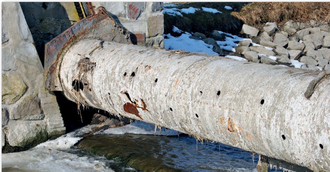
Předseda MO ČRS Rožďalovice Bohuslav Burian upozornil na špatný stav manipulačního tělesa jezu na Mrlině. Město nechalo v součinnosti s Povodím Labe vypracovat odbornou firmou posudek, který jeho havarijný stav potvrdil. Odbor životního prostředí MěÚ Nymburk rozhodl dne 15. února 2017 o nápravném opatření „v souladu s § 110, odst. 1 vodního zákona, spočívající v uvedení válcového jezu do neškodného stavu“. Předběžné náklady na rekonstrukci celého systému jsou odhadnuty na 3–5 milionů Kč. Město se pokusí nalézt vhodný dotační titul, který by pokryl co největší náklady případné opravy
